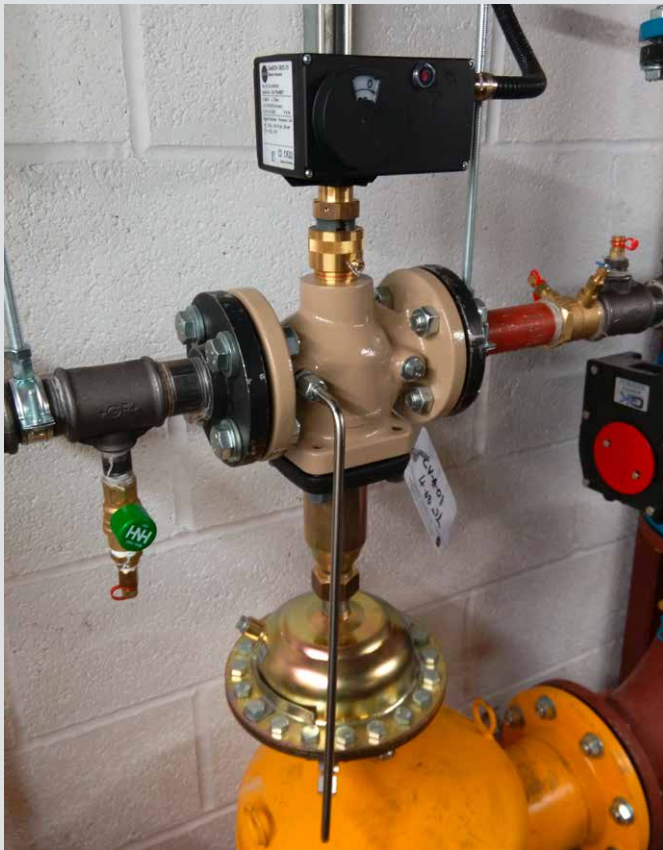
Bild 3: Elektrisches Stellventil mit Volumenstromregler zur Steuerung des Primärbypass
