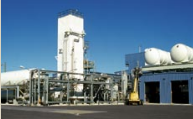
Impianto di liquefazione di elio della Air Products. L'elio liquefatto ad una temperatura vicina allo zero assoluto è un eccellente refrigerante.
